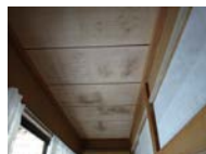
(b) 棲みつきによる天井汚損
