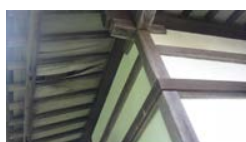
(a) 屋根裏侵入口と柱の掻き傷
